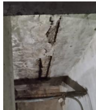
Fig. 3- Corrosión del acero de refuerzo en las vigas de la planta baja del edificio B.
