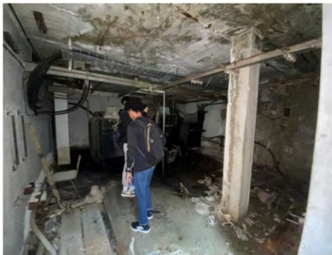
Fig. 2- Presencia de humedad en la planta baja del edificio B.
