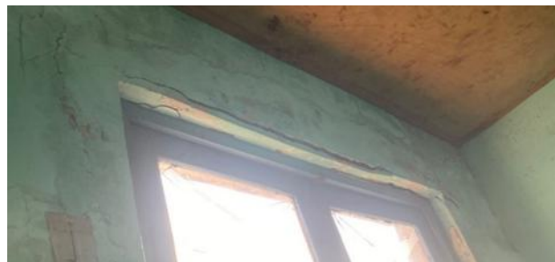
Fig. 4- Presencia de grietas longitudinales en los dinteles de las ventanas del edificio A
