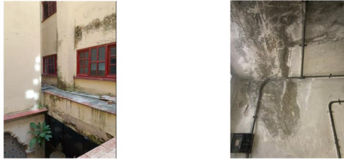
Fig.6- Filtraciones en muros y losas.
