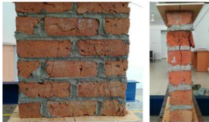
Fig. 2- Formas de ruptura mostrados en los ensayos experimentales realizados. Fuente: [5]
