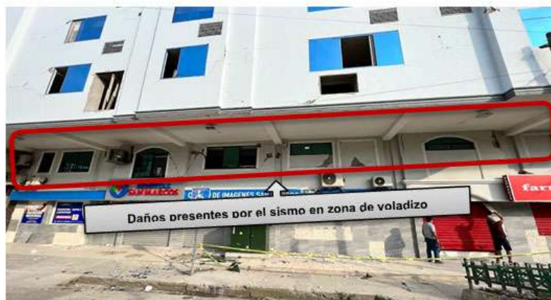
Fig. 16- Daños evidenciados en fachada de la clínica San Marcos [Elaboración propia].
