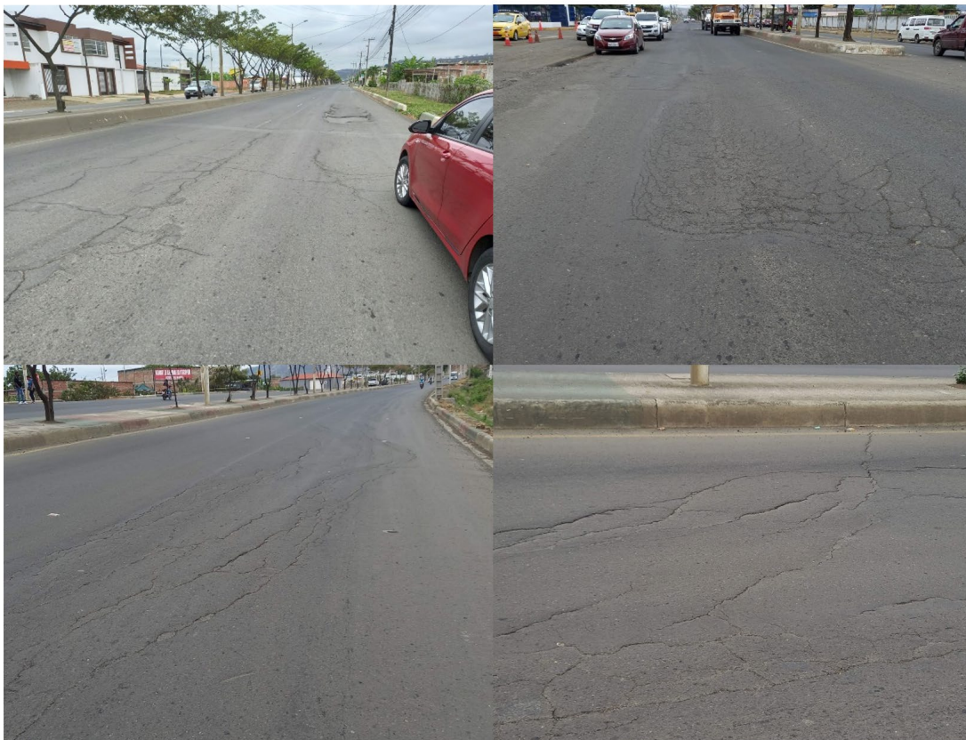
Figura 2. Fallas detectadas durante la inspección visual en el pavimento flexible del paso lateral Manabí Guillem Vélez
