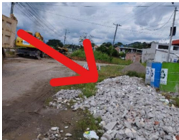
Figura 12: Desperdician en la obra. Fuente: Elaboración propia
