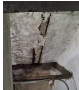
Fig. 3- Corrosión del acero de refuerzo en las vigas de la planta baja del edificio B.
