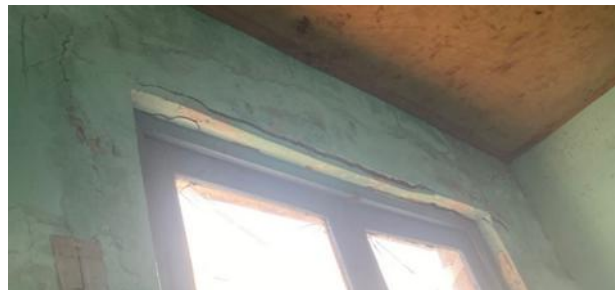
Fig. 4- Presencia de grietas longitudinales en los dinteles de las ventanas del edificio A
