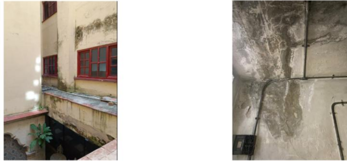
Fig.6- Filtraciones en muros y losas.
