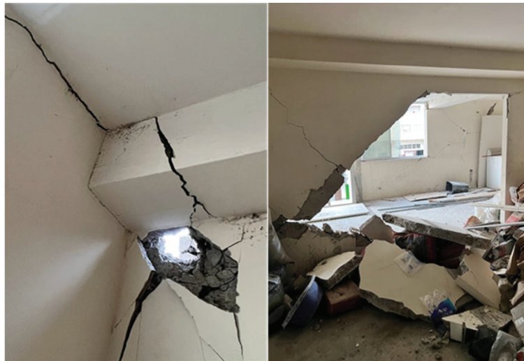
Fig. 17: Daños en la parte interna de la zona de voladizo. a) Fallo por corte en viga b) Colapso de pared interior [Elaboración propia].
